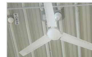
Neue Deckenventilatoren sorgen für Luftzirkulation.
